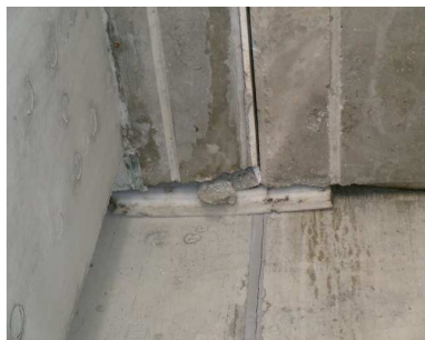
① 바닥판하면 S1 파손 - 진전 여부확인
