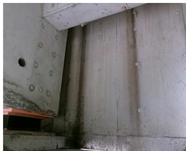
③ 교대 A2 균열 - 진전 여부확인
